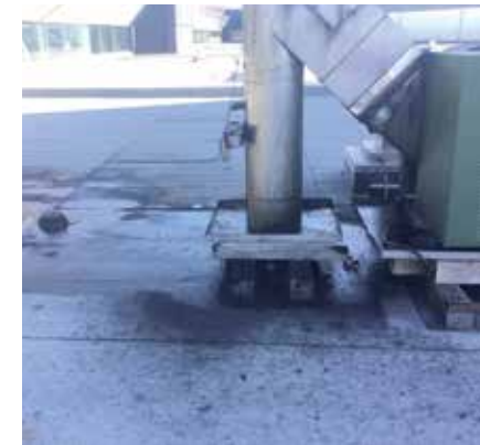
BAC DE RÉCUPÉRATION DES GRAISSES (DÉVERSEMENT)
